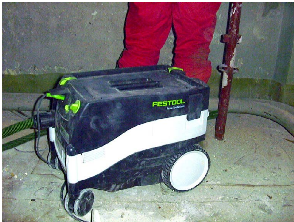
4.2. attēls. Betona putekļu savākšanas iekārta
