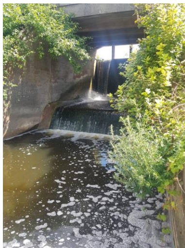
Sudmaļu dzirnavu ezera hidrotehniskā būve uz Pūres upes (2019.g.)
