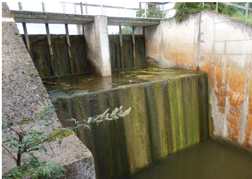
5. attēls. Šlokenbekas HES uz Slocenes (nav ūdensobjekts) (foto: L. Grīnberga)
