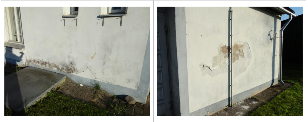
Skats uz ēkas fasādi – konstatēts būtisks sienu bojājums/mitrums un plaisas.
