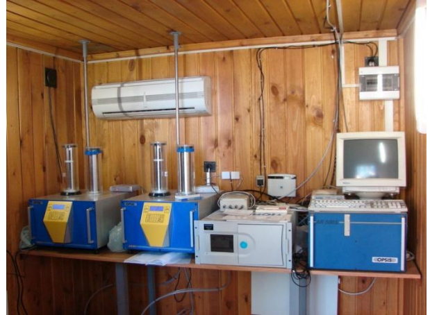
3.5.1.3. attēls. Stacijas Liepāja-Kalpaka iela mēraparatūra konteinerā
