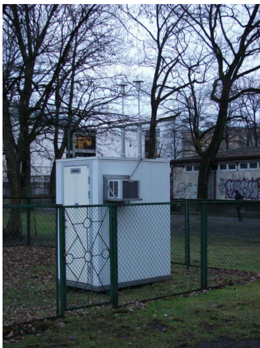
4.3.3.2. attēls. Stacija Rīga-Kronvalda bulvāris konteiners, Kronvalda bulvārī 4
